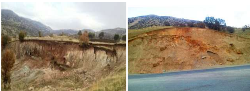
شکل ۳: نمونه‌هایی از دامنه‌های لغزشی در منطقه‌ی جوانرود
