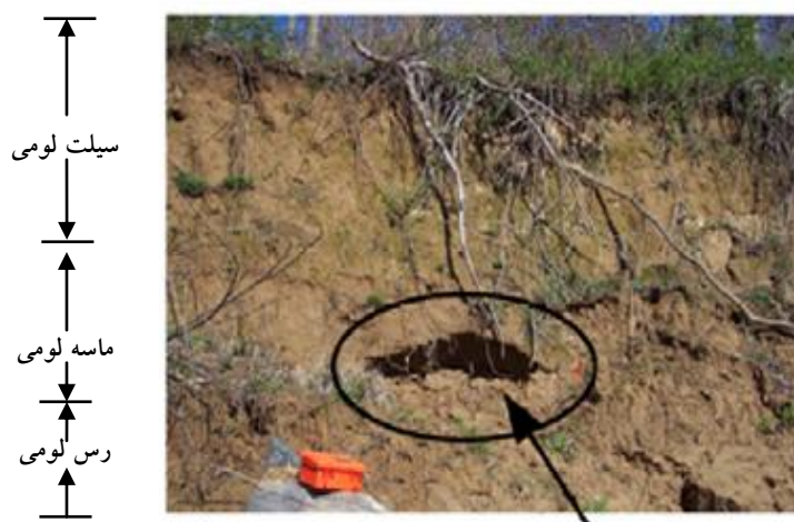
فرسایش ناشی از تراوش
